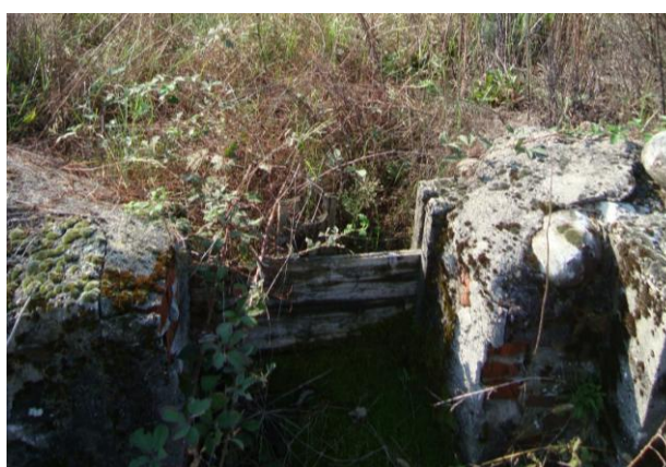
Fig. 6 - Esempio di paratoia in legno da sostituire.
